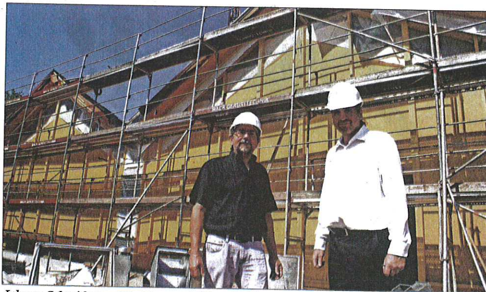
Johann Schmidt vom Hochbauamt (l.) und Nils Jakoby zeigen die Fassade, an der eigentlich eine Glas- statt einer Holzwand stehen müsste.
